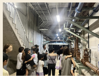
たくさんの配管が通っている地下
